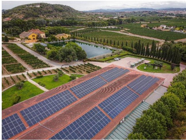
Figura 10. Impianti fotovoltaici della famiglia Torres. Fonte: Famiglia Torres
