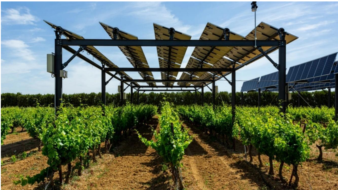
Figura 15. Installazione del sistema di "ombreggiatura intelligente" della cantina San Gabriel. Fonte: Laura Cano Liébana, 2022
